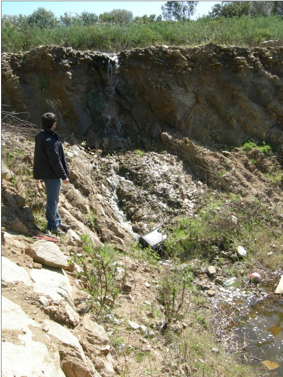
Figura 28 – Foto acquisita il 21/03/2013 nel settore est del fronte di scavo meridionale. Punti di immissione di acque di ruscellamento superficiale all'interno della darsena.
