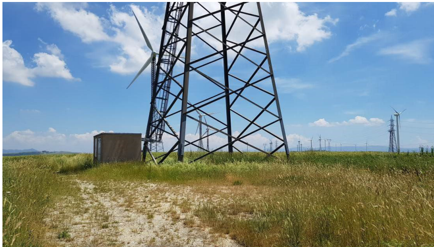
Figura 9: parte degli aerogeneratori della fila da BS36 a BS42.
