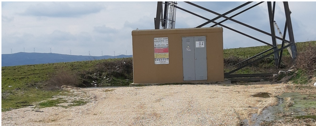
Figura 16: cabina di trasformazione prefabbricata e piazzola degli aerogeneratori esistenti
