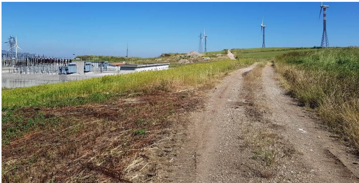
Figura 15: tratti della strada che serve l'impianto esistente e da cui si accederà per la realizzazione degli aerogeneratori con sigle da R-BS01 a R-BS10. In alto si notano i danni fatti dal ruscellamento dell'acqua sulla sede stradale causato dalla cattiva tenuta delle cunette stradali. La strada avrà bisogno di sistemazione delle cunette, di interventi di allargamento della sede carrabile, di rifacimento della massicciata e di ricarica puntuale con stabilizzato di cava.
