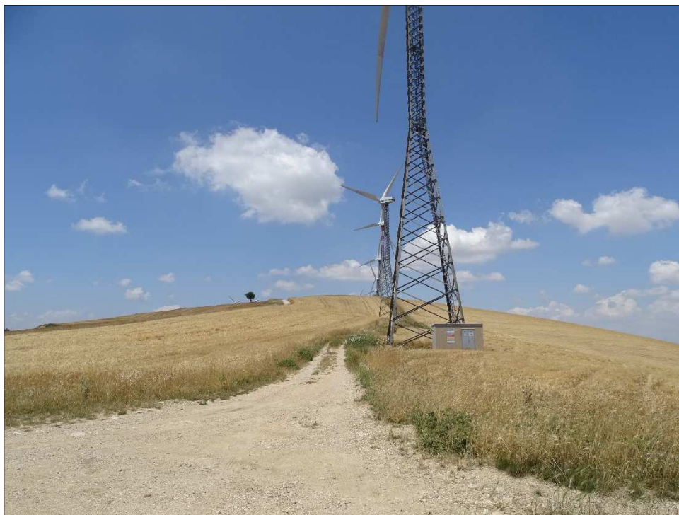
Figura 3: Vista postazione aerogeneratore esistente con la relativa cabina di macchina
