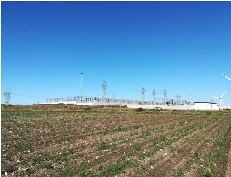
Figura 11 – Stazione Deliceto Esistente in prossimità della quale è prevista la realizzazione della stazione di trasformazione.
