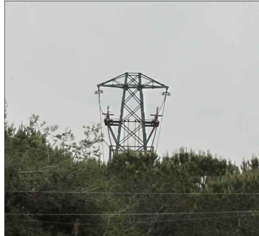
SOSTEGNO DI TRANSIZIONE AEREO/CAVO
