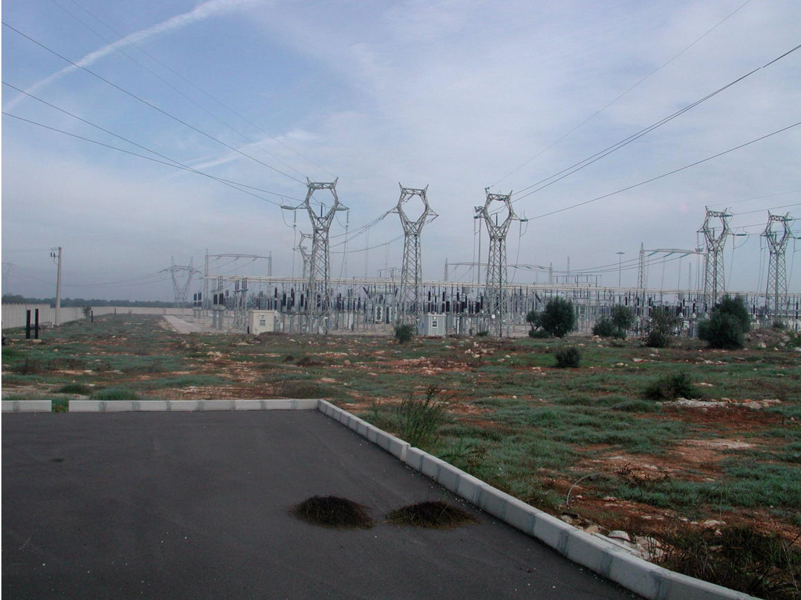
Foto 1 Stazione di trasformazione
