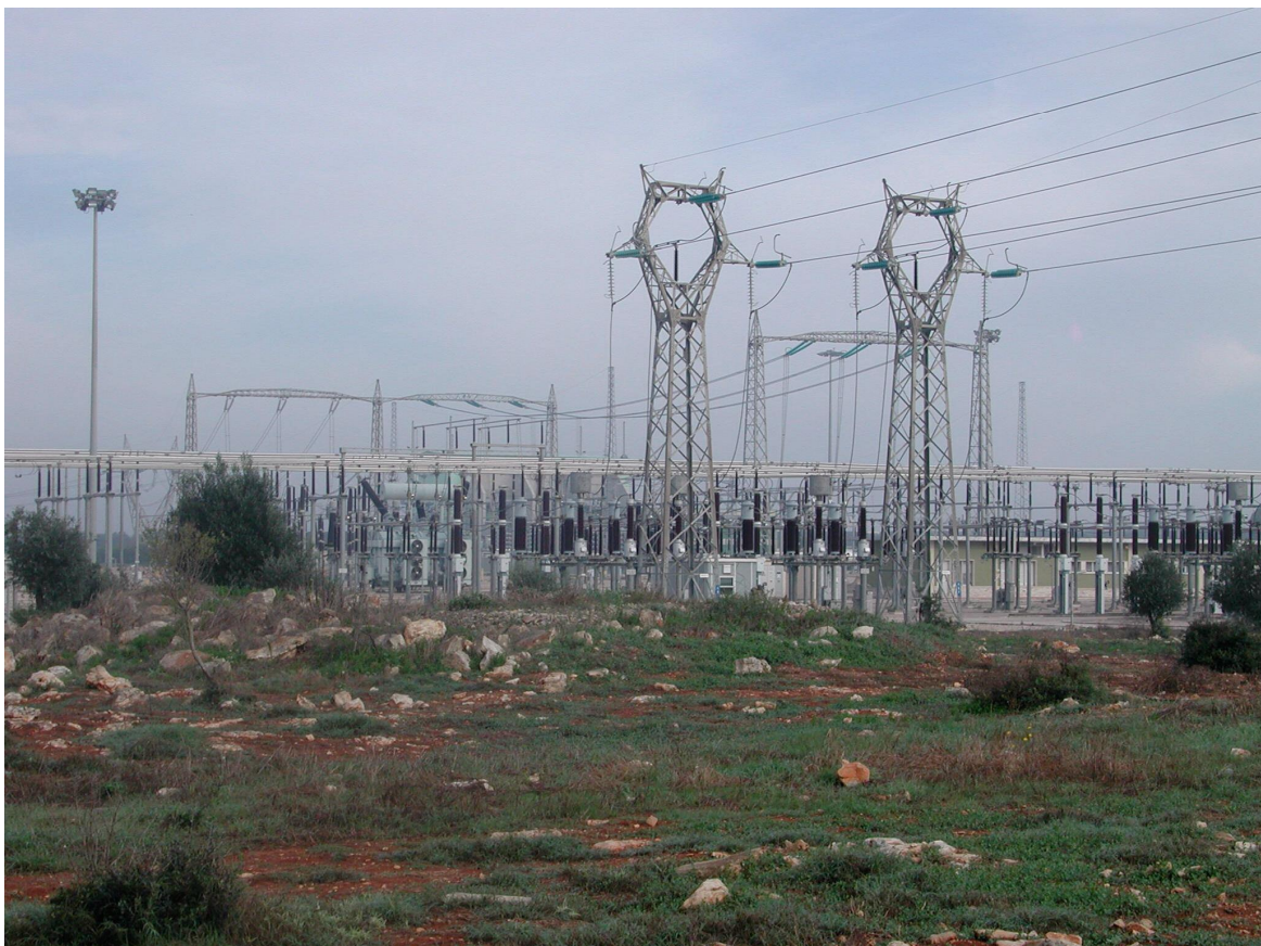
Foto 3 Stazione di trasformazione
