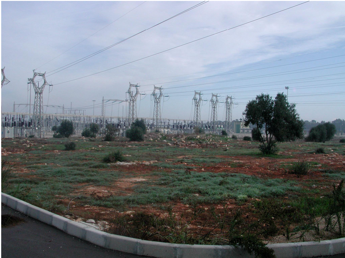
Foto 2 Stazione di trasformazione
