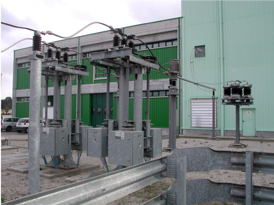
Foto 18 Montante AT 400 kVcc: linea dei terminali di ritorno MT del cavo terrestre
