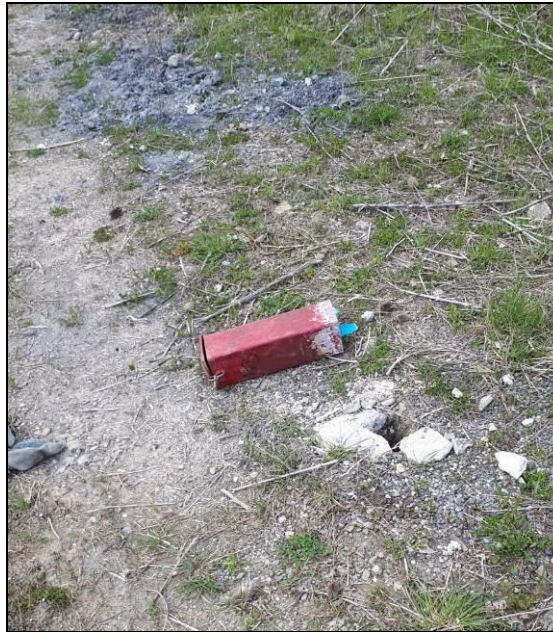
Figura 36 – Piezometro M3 danneggiato
