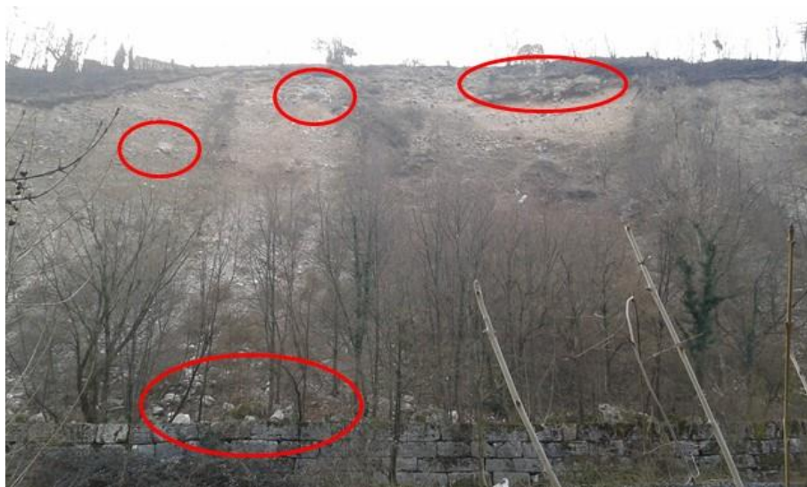
Figura 3 - La superficie di frana accanto al viadotto Piovene permette di osservare più chiaramente la natura del materiale inglobante frammenti ciottoli, massi e orizzonti superficiali ben cementati
