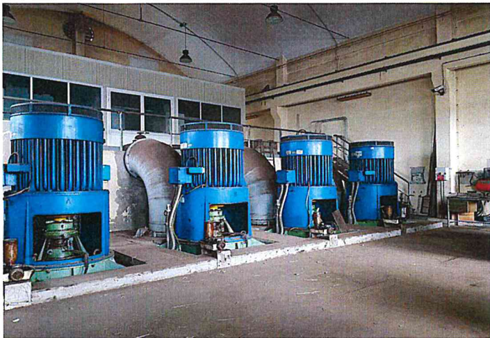
Panoramica motori pompe acqua-mare
