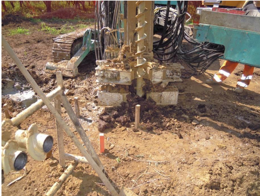
Figura 26 - Macchina operatrice per la realizzazione di micropali tubfix; sistema di scavo mediante trivella elicoidale
