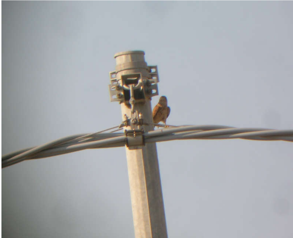
Fotografia n. 9.a – Gheppio posato cu palo BT lungo strada comunale Deliceto-Ascoli.
