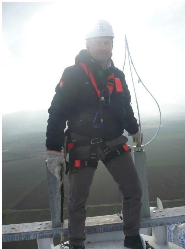
Figura 4: Attività di controllo anemometri e segnalazione aeronautica – Parco Eolico di Proprietà - Puglia
