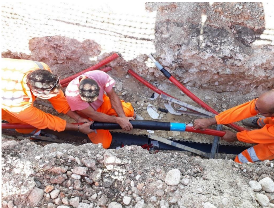
Figura 7: Individuazione e sostituzione giunto (giunti a freddo) – Parco Eolico di proprietà - Puglia
