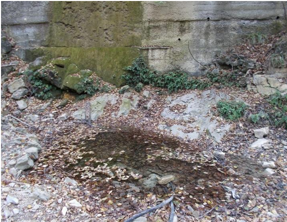
Figura 20 – Opera di presa PS007 a valle di briglia in cemento armato; l'accumulo idrico viene captato da due tubazioni in PEAD.
