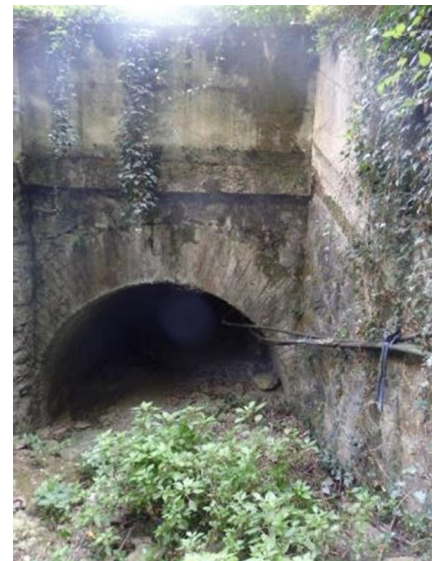
Figura 6 – opera di attraversamento ferroviario parzialmente ingombra del trasporto solido del rio.
