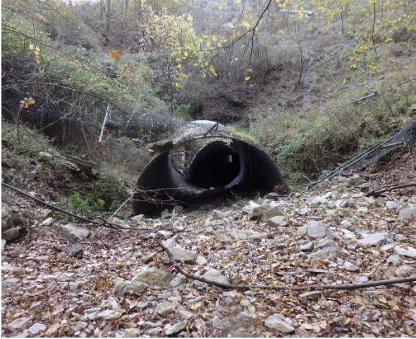
Figura 14 – Imbocco in dissesto lato monte dell'opera di attraversamento della rampa di accesso alla A12.
