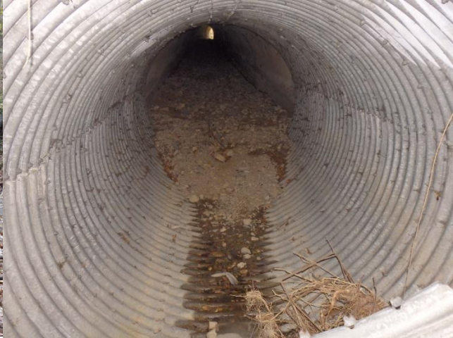
Figura 15 – Parziale intasamento interno della tubazione ARMCO per elevato trasporto solido.
