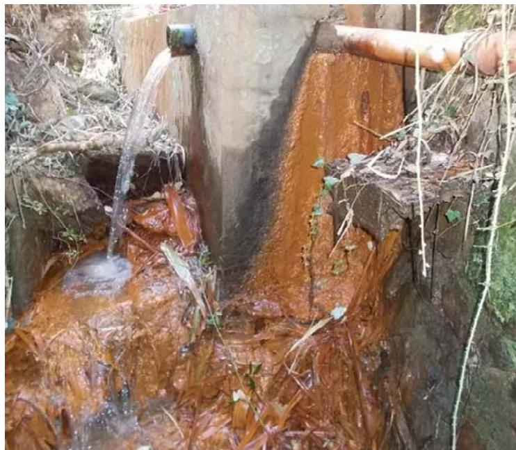
Figura 3-3: Scarico del drenaggio della galleria Borgonuovo della A10 (S209). La formazione di evidenti concrezioni di ossidi di ferro attesta che si tratta di acque che si sono evolute in ambienti fortemente riducenti.
