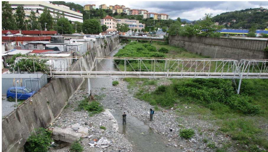
Figura 3-10: scarichi attivi in destra idrografica sul torrente Burla.
