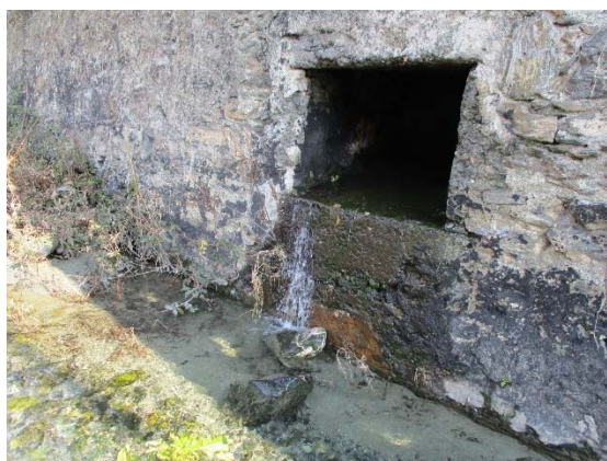
Figura 3-4: scarico attivo localizzato circa 100 m a monte della sezione NG-GE-SU-CE-07.
