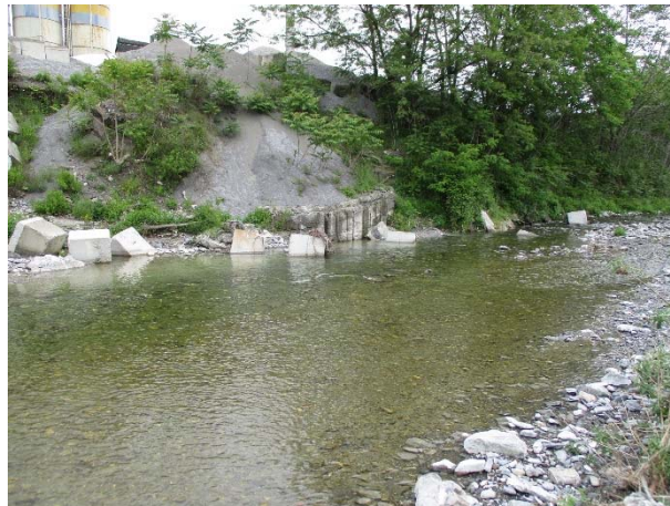
Figura 3-12: cumulo di sabbione in corrispondenza della sezione NG-GE-SU-SE-37.
