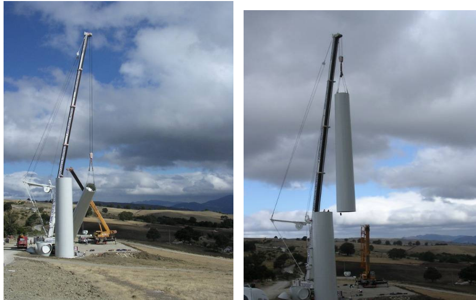
Figura 8 – Montaggio dei conci della torre
