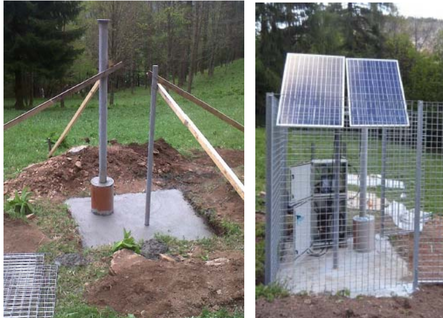
Figura 31 - Installazione tipo sensore con postazione alimentazione
