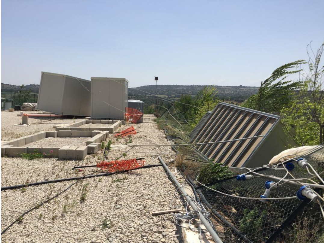
Figura 11 – immagine delle cabine danneggiate il giorno 29/04/2018
