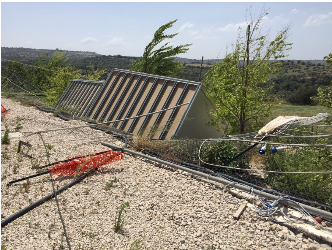
Figura 12 – immagine di dettaglio delle cabine danneggiate il giorno 29/04/2018
