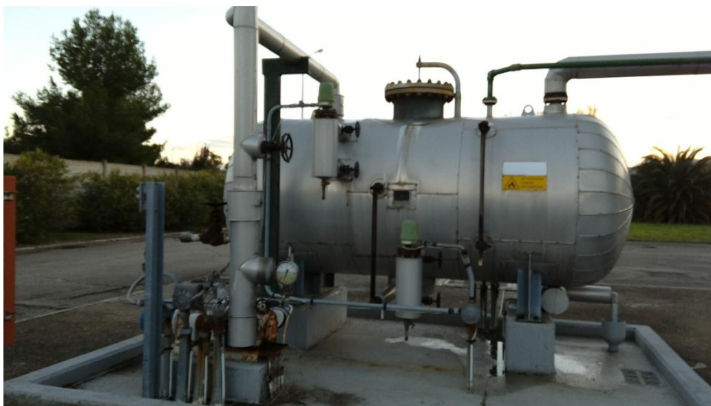
Foto4: serbatoio di raccolta impianto di trattamento acque reflue.
