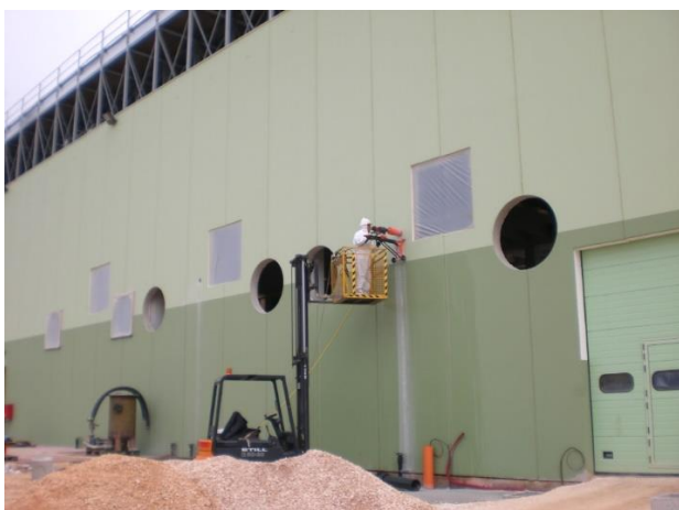
Figura 27: Foto di repertorio 1 – Taglio moduli dell'edificio in cui è installata l'impianto BL2
