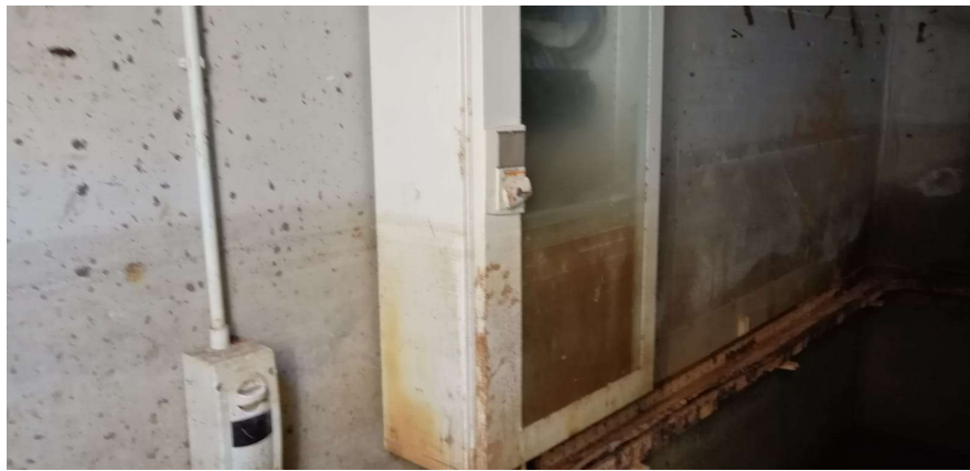
Locale tecnico interrato della centrale del vuoto - interno
