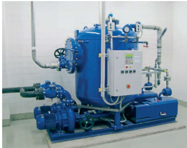
Centrale del vuoto preassemblata
