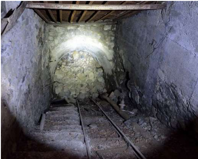
Galleria con ingresso ostruito da detriti.
