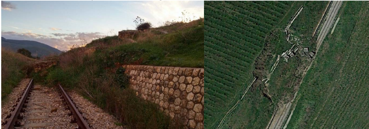
Frana al km 92+850, si riporta anche una foto aerea del dissesto.
