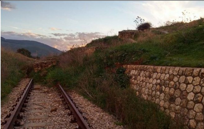
dissesto del tratto in trincea
