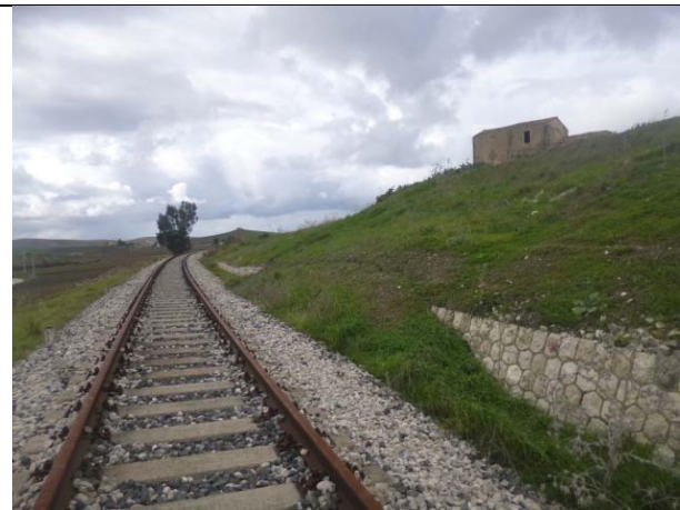
frammenti di materiale sulla sede ferroviaria, con scavalco dei muri di sostegno esistenti
