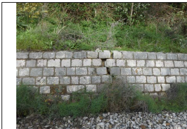
Esempio di fessurazione nel muro di sostegno
