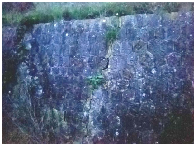
fessurazioni dei muri di sostegno laterali
