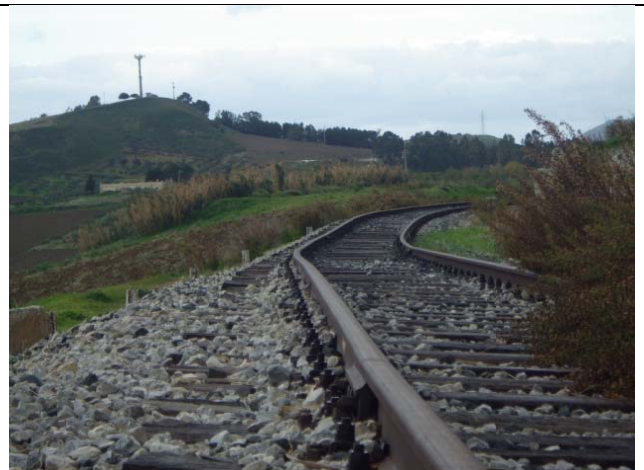
cedimento del piano ferroviario
