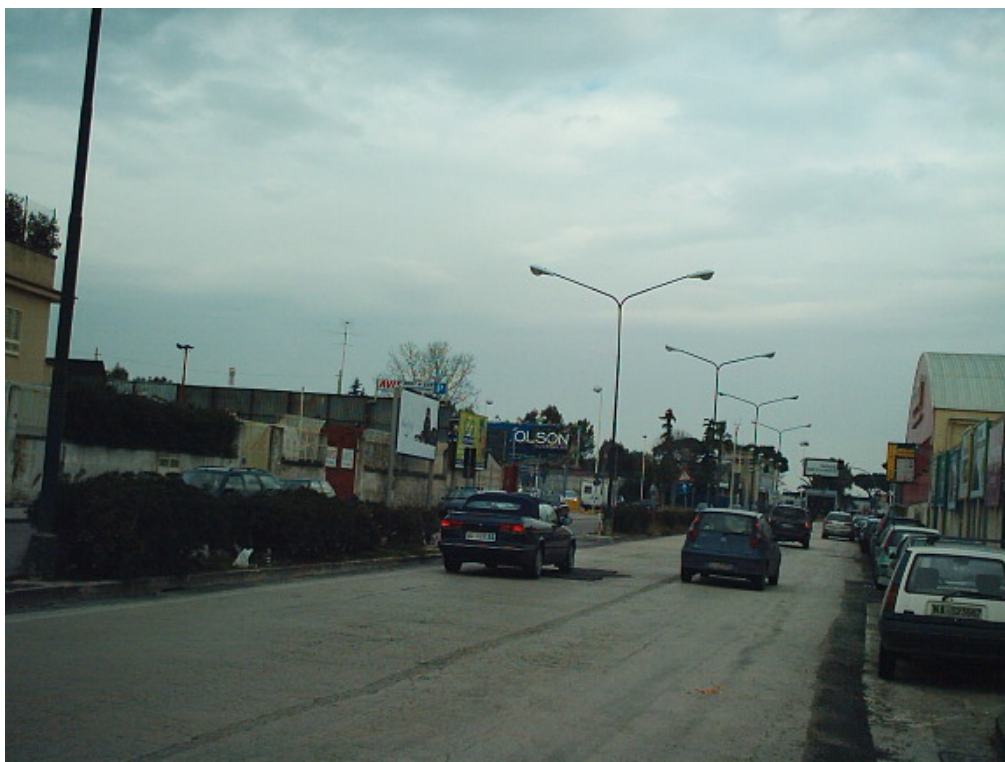
Figura 13 – Degrado diffuso su Viale Ruffo di Calabria
