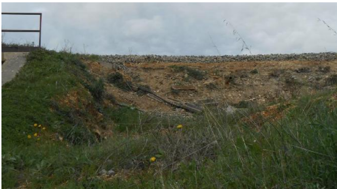
3.2 Esempio di frana rilevato lungo la linea
