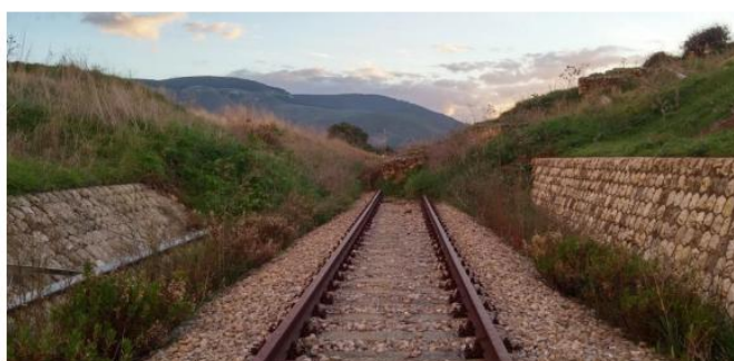
Figura 3.1 - Foto rappresentative dei fenomeni rilevati nei tratti in trincea (km 109 e 112)
