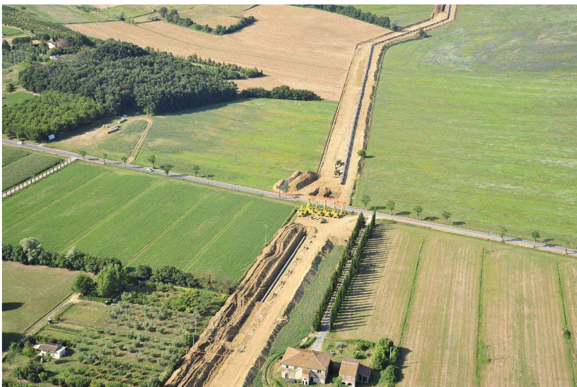
Fig. 2.6 – Panoramica dell'area di un tratto di metanodotto soggetto a TOC per l'attraversamento di un'infrastruttura viaria.
