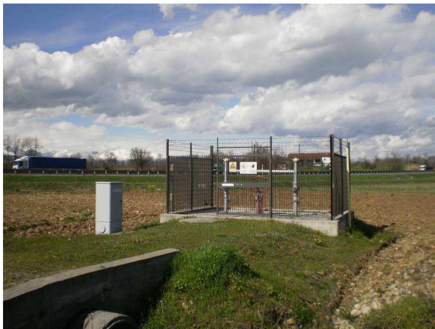
Fig. 2.2 - Esempio di impianto di intercettazione di linea PIL.
