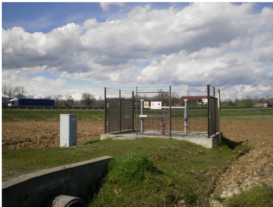
Fig. 3.5 – Esempio di impianto di intercettazione di linea PIL. Nel caso in esame l'impianto verrà opportunamente mascherato con essenze arbustive (vedi § 7.3.1)
