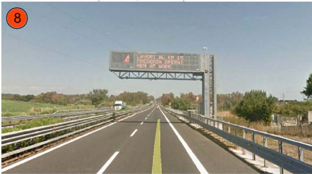
PMV esistente in carr.sud al km 17+940, posto ad una distanza di circa 2km prima dell'inizio dell'uscita dello svincolo di Torrimpietra
