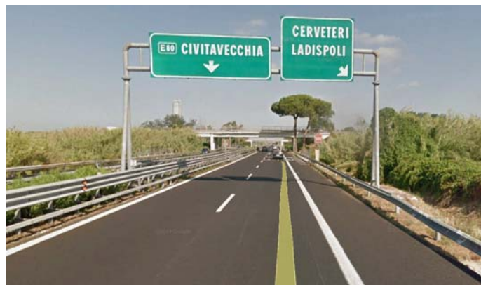
Figura 15: portale esistente a cavalletto in carr. nord da sostituire (km27+600)
