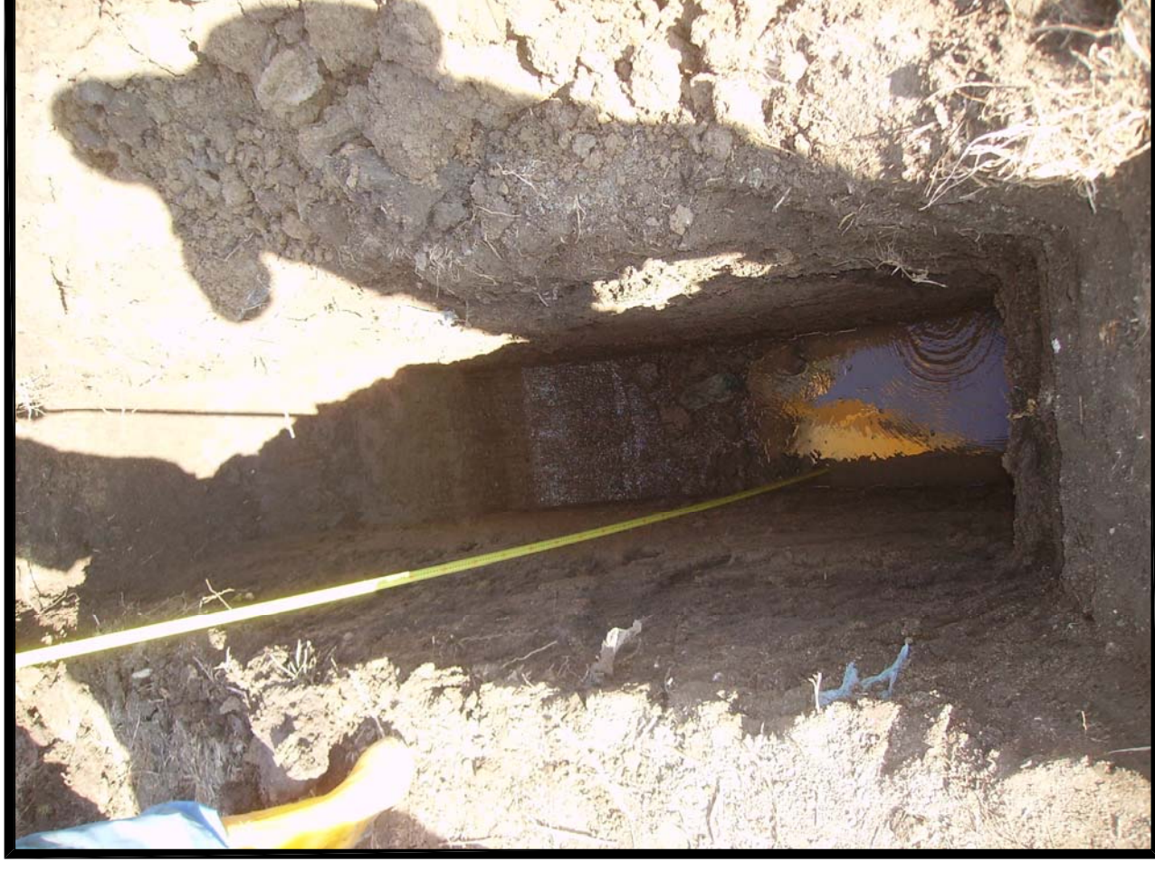
NOTE: Fuoriuscita di acqua a partire da 3,00m.
