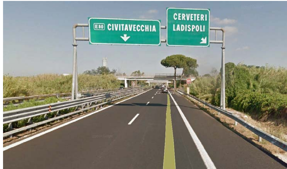
Figura 2-23. portale esistente a cavalletto in carr. nord da sostituire (km27+600)
