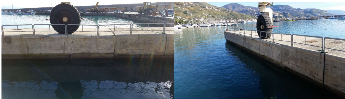
Figura 7.4 Cedimento via di corsa travel lift
