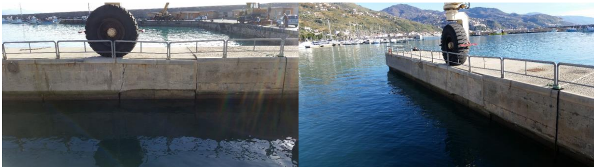
Figura 3-4 Cedimento via di corsa travel lift
