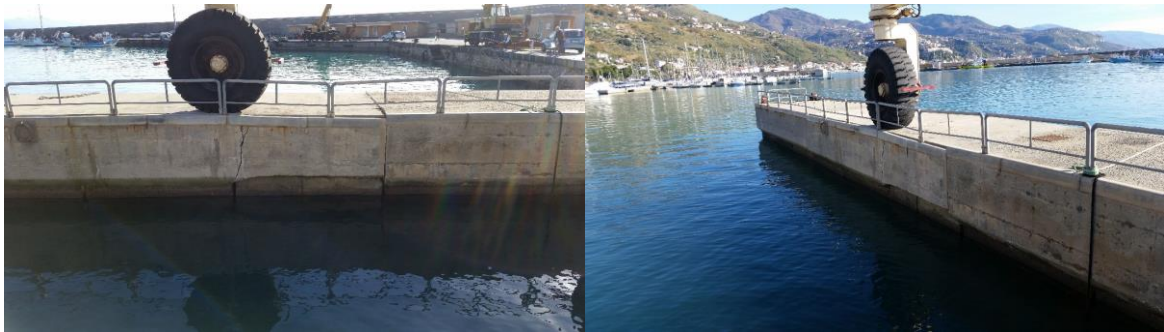
Figura 2.3 Cedimento via di corsa travel lift
