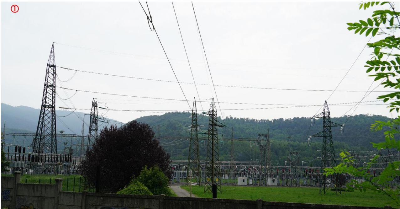
Fig. 3. Sottostazione Terna di Nave (BS)
