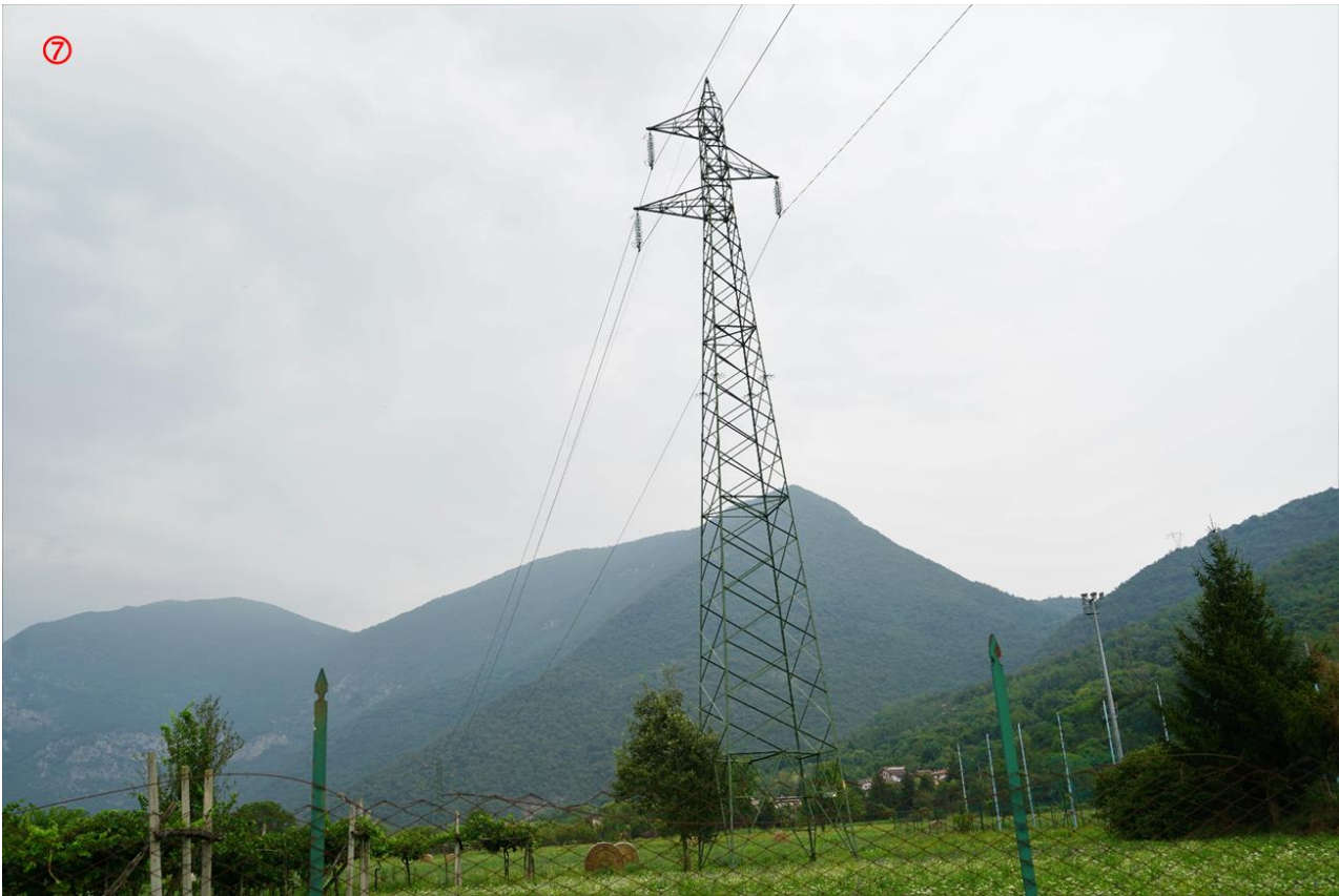
Fig. 9. Elettrodotta 123 su area agricola
