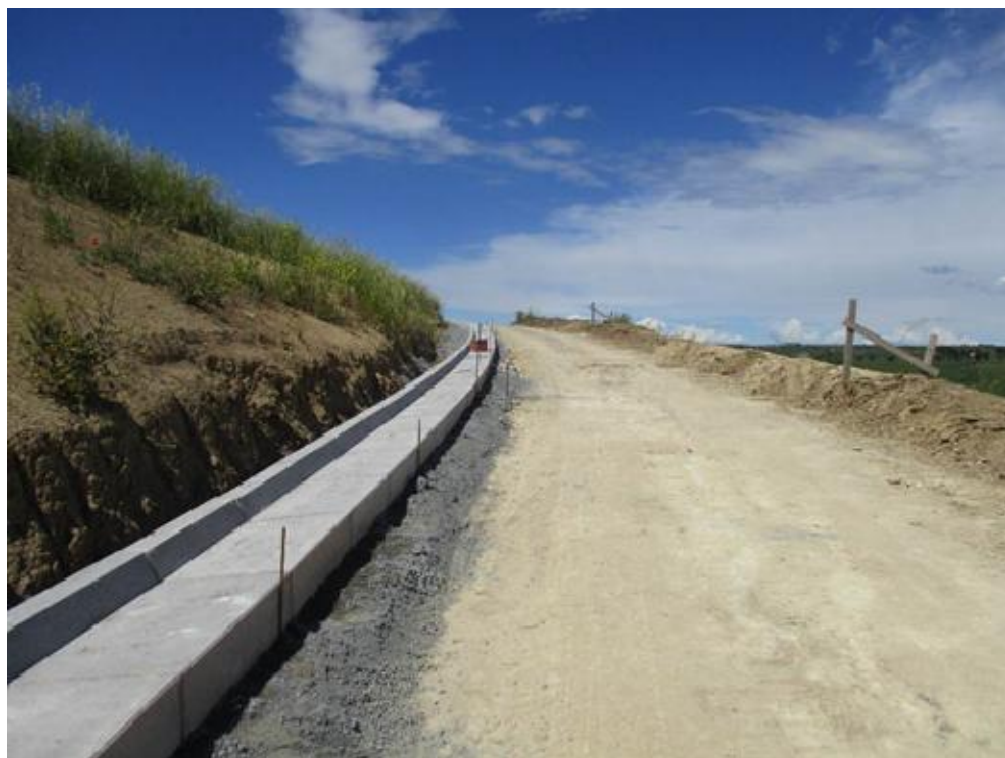
INP 200A Cunetta alla francese in Dx tra la sez. 25 e la sez. 30 circa
