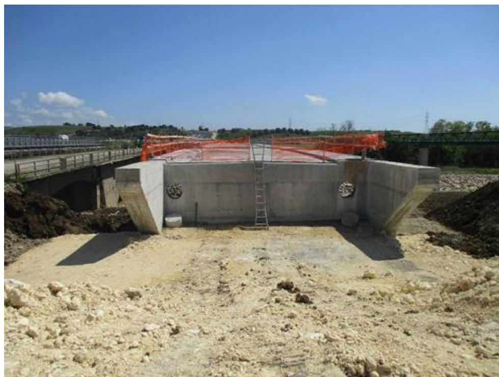
INP 200B - Formazione corpo del rilevato in approccio alla spalla A del viadotto Mignone
