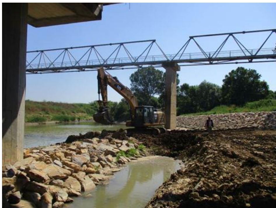
Riprofilatura alveo fiume Mignone – Intervento finale sui sedimi svincolati dall'interferenza delle FFOO
