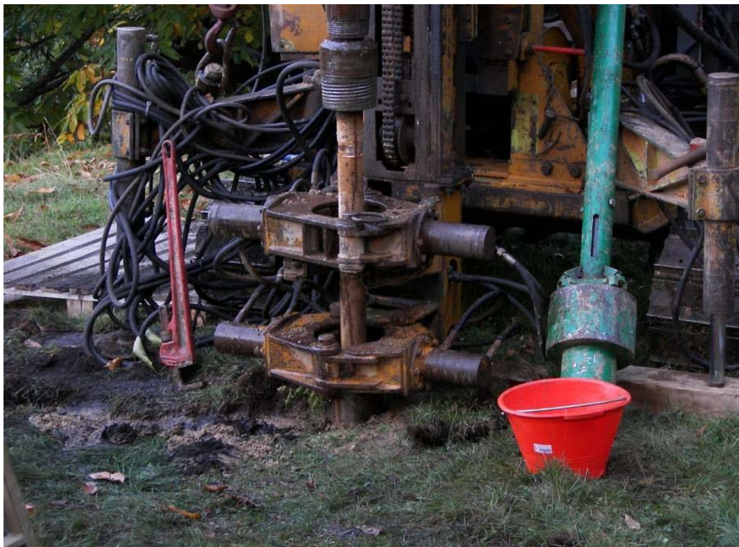
Figura 9-7: Macchina operatrice per la realizzazione di micropali tubfix; sistema di scavo a rotopercussione
