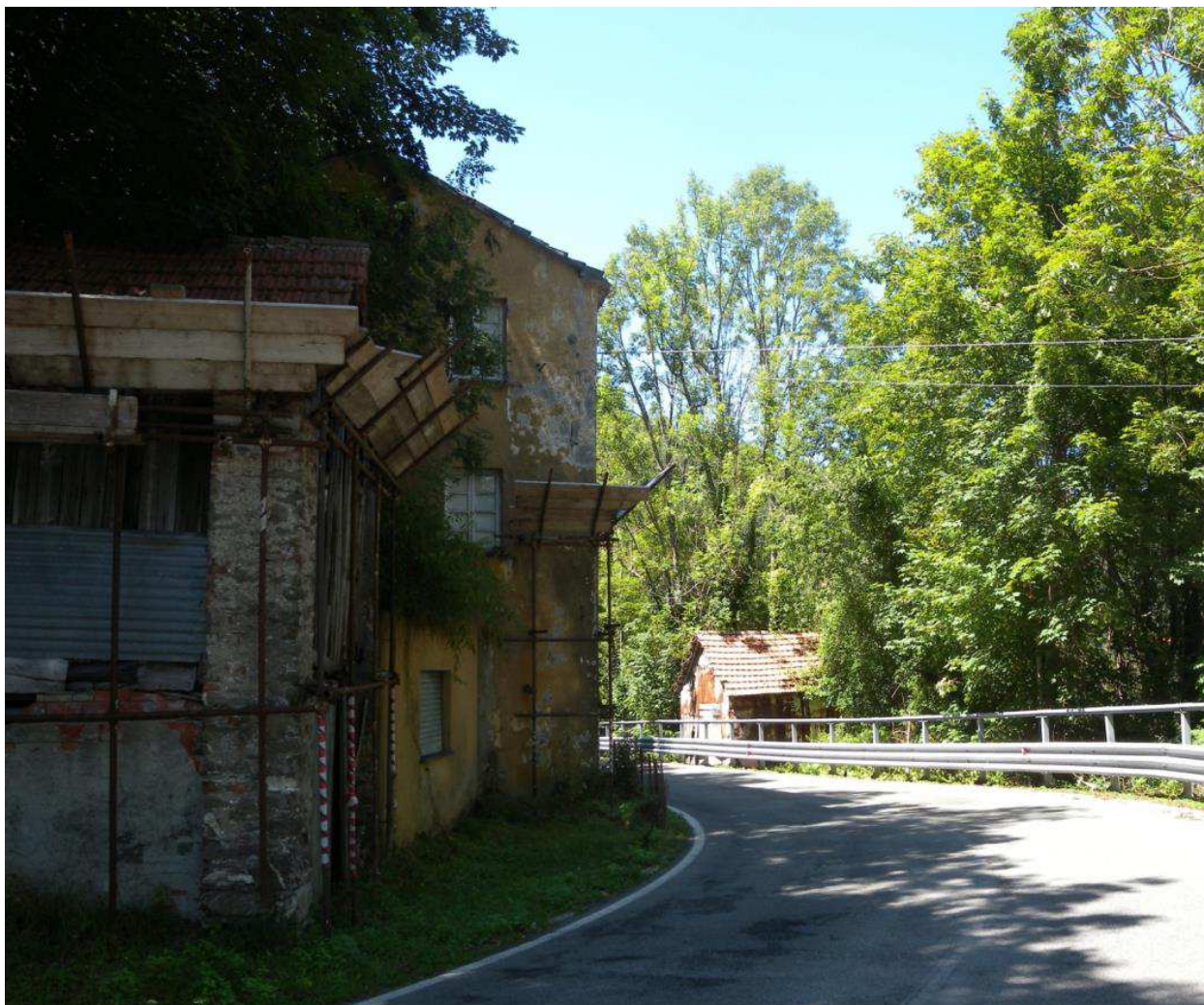
Figura 22: Esempio di architettura in stato di abbandono e degrado lungo la SS 45
