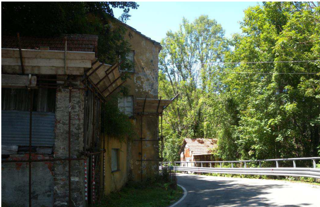
Figura 18: Esempio di architettura in stato di abbandono e degrado lungo la SS 45
