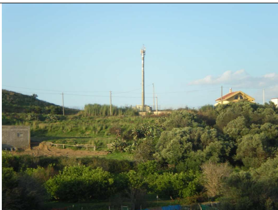
Linea BT su viabilità poderale
