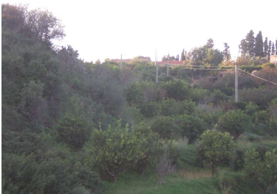
Linea BT su viabilità poderale
