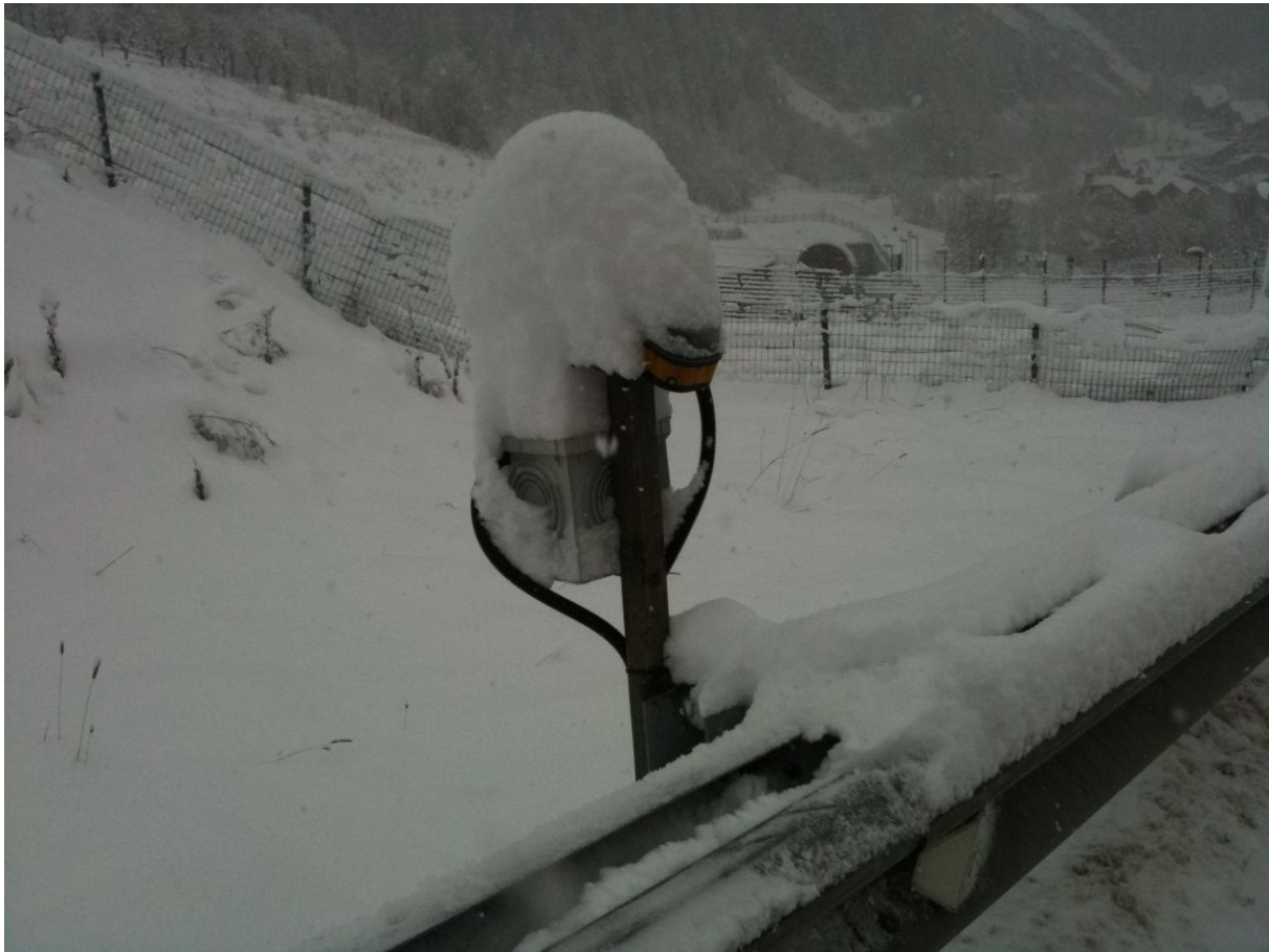
Figura 12 Installazione montana nodo IEDG
