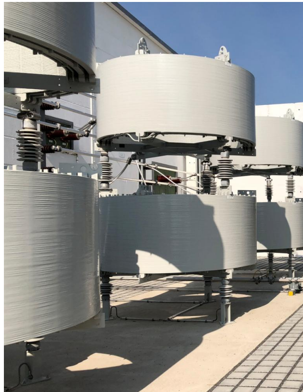
Figura 4.20 – Compensazione del reattivo - cabina di consegna
