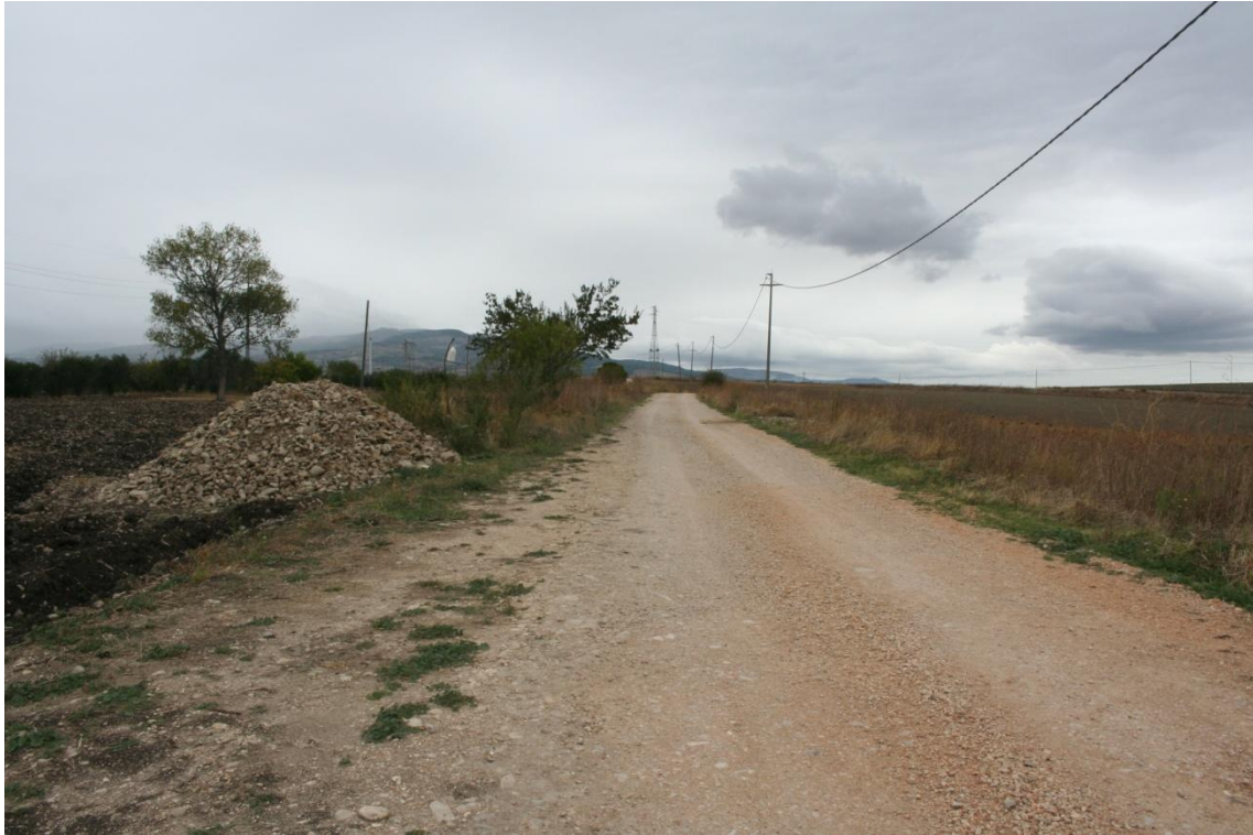
5 - Troia (FG), loc. Vigna Cancarro: cavidotto di interconnessione alla T12 corrente lungo tratturo Titolone, panoramica direzione NW
