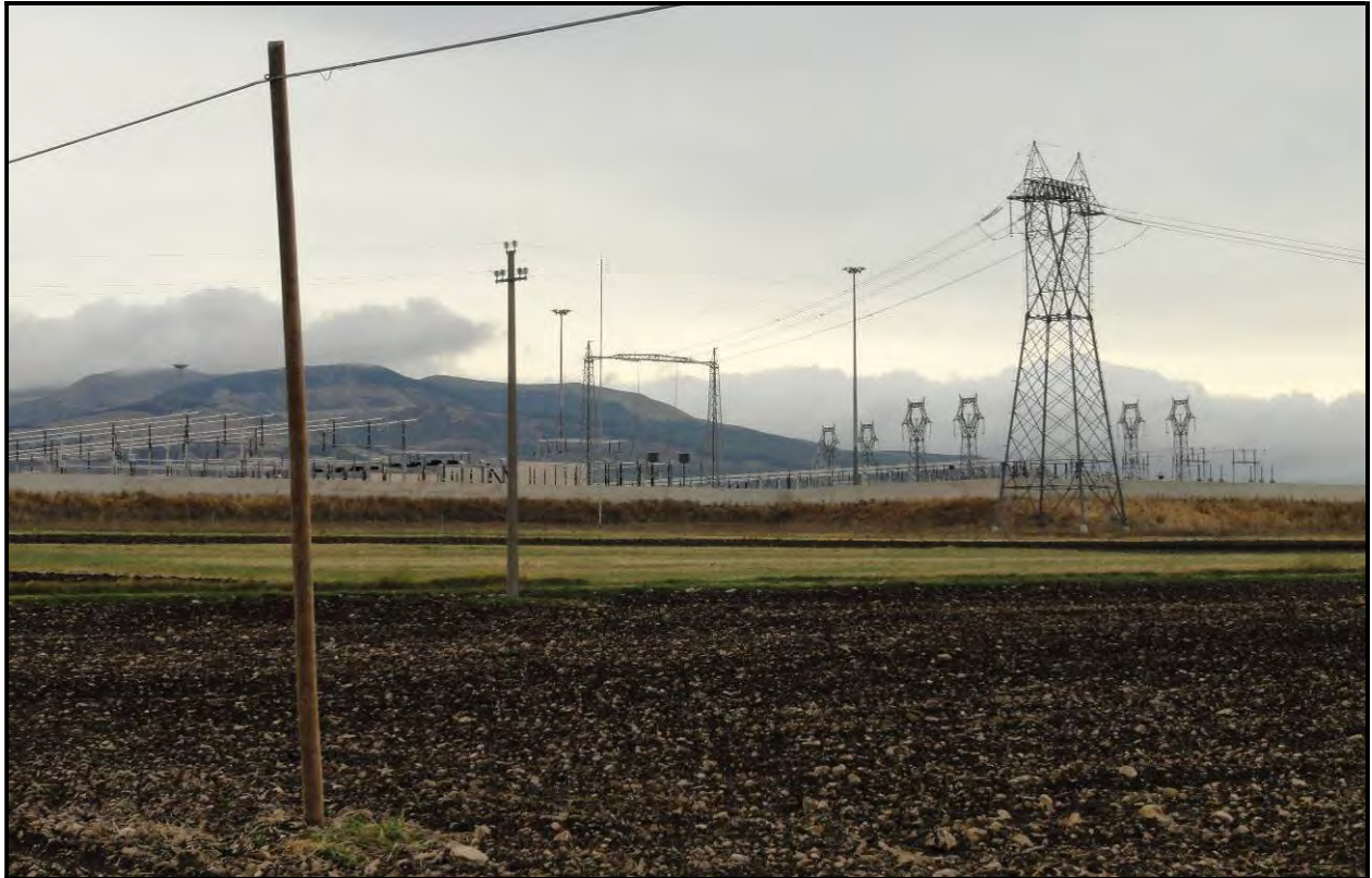
Foto 1: l'area dove sorge la sottostazione esistente "Troia" e sorgerà l'ampliamento della sottostazione "Troia", vista da Sud-Est
