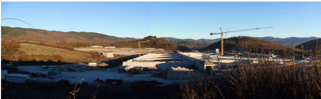
Figura 56: vista verso Montebuiano (a sinistra) e delle Donne (a destra) con evidenza del grande cantiere per la nuova area di servizio Bellosguardo
