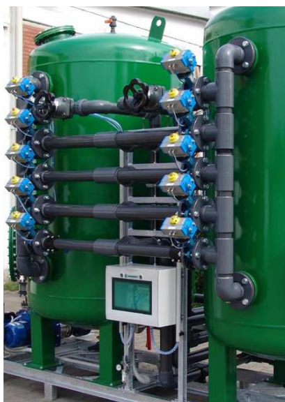
Figura 9: Stazione automatica con filtri a c.a.
