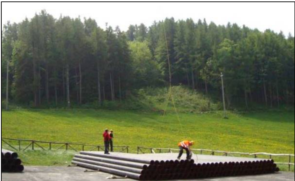
Fig. 3.1.1: Piazzola di accatastamento tubazioni
