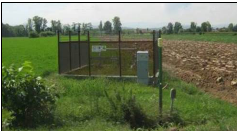
Fig. 3.1.12/A: Installazione tipo impianto di linea con pannelli in grigliato di ferro verniciato
