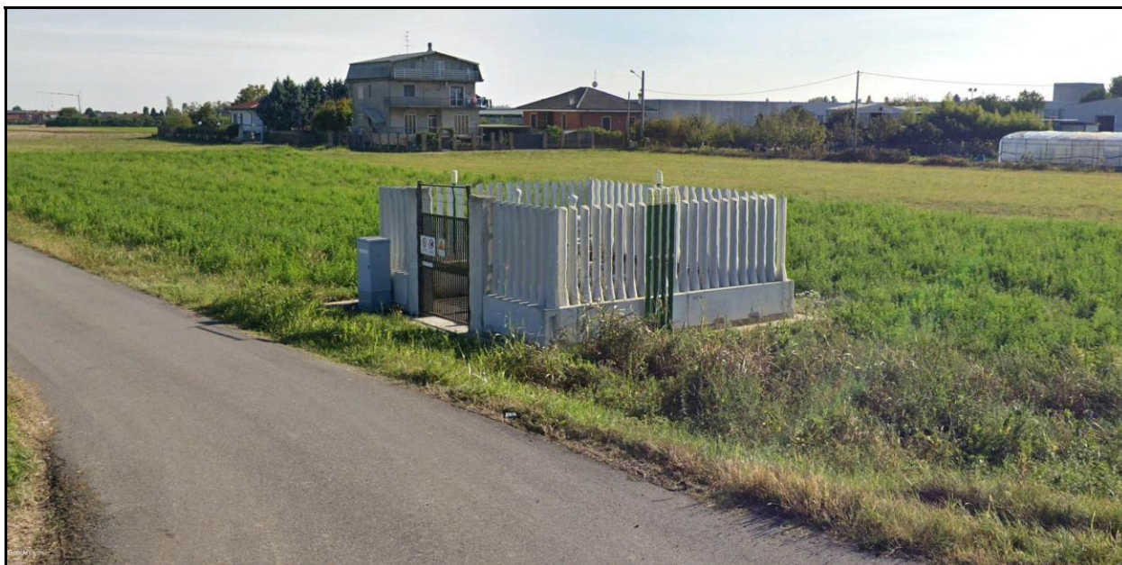
Fig. 5/D: Installazione tipo impianto di linea con recinzione in pannelli in cls prefabbricati
